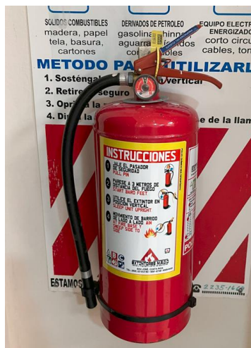
Ilustración 1 Extintor de polvo químico no listado
