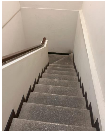
Ilustración 4 Escalera que no cumple con el dimensionamiento, ni las dimensiones, ni en los pasamanos
