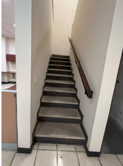
Ilustración 3 Única escalera de acceso al segundo nivel, sin proteger y con descarga interna.
