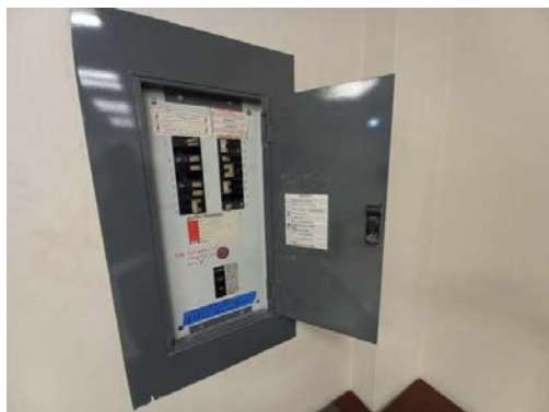
Centro de carga
