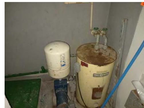
Tanque de captación y bomba
